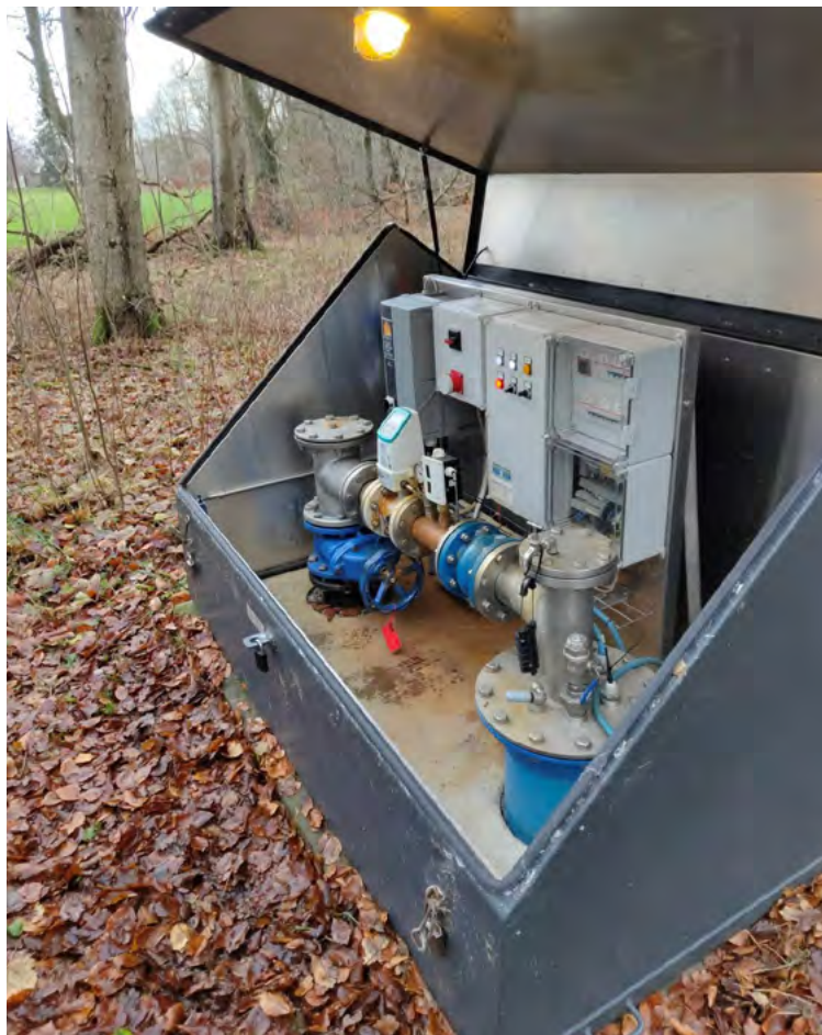
Hvis strømmen til vores borerer svigter, kan der slås over på nødgenerator.
