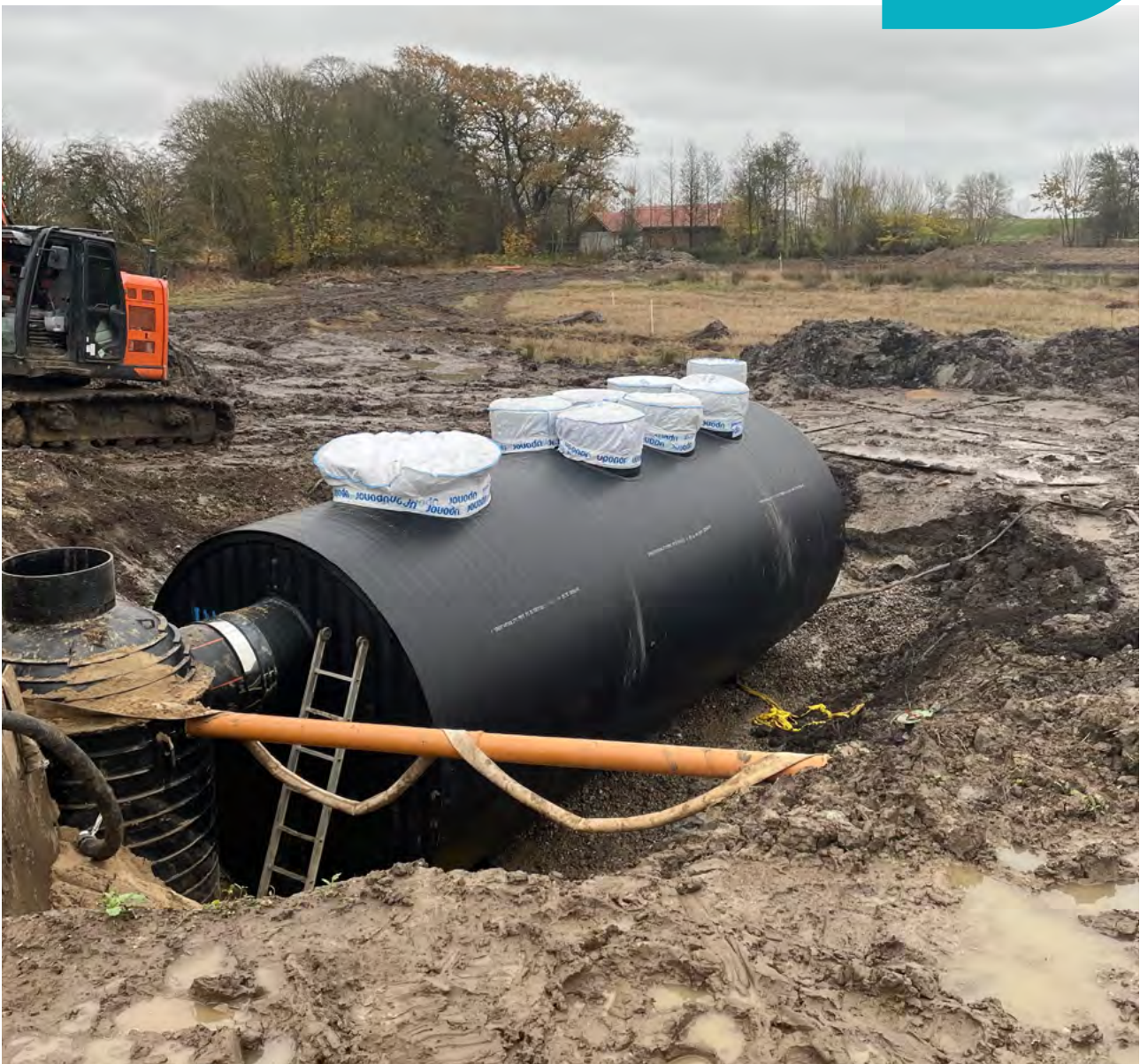
På billedet ses den specialdesignede Vault, som er den løsning vi har valgt til håndteringen af regnvand i Fremtidsparken.
